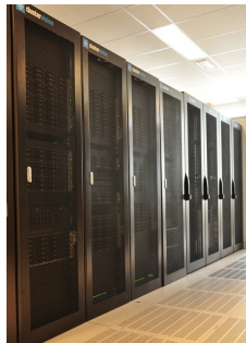
Local data center
